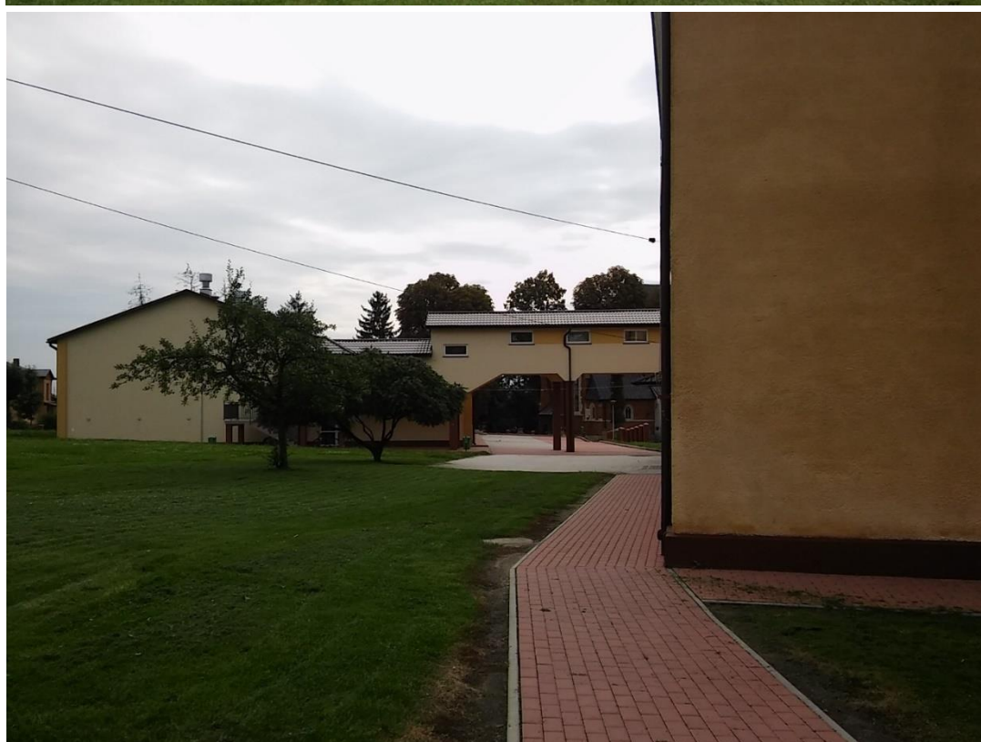
Bejsce, budynek Szkoły Podstawowej w Bejskach wymagająca termomodernizacji (fot. P. Pietruszka – FRESH-BIZ)
